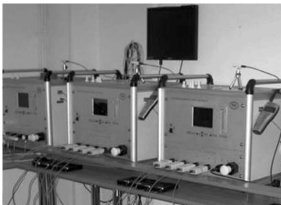
Рис. 1. Калибровочный центр, оборудованный группой генераторов ТКА-ГВЛ-01
